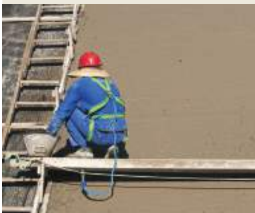
Concretagem da transposição do rio São Francisco, no município de Salgueiro (PE), em 2010.
