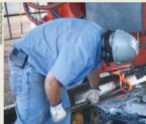
Equipamentos de soldagem de trilhos no canteiro de obras da ferrovia transnordestina, no município de Salgueiro (PE), em 2011.
